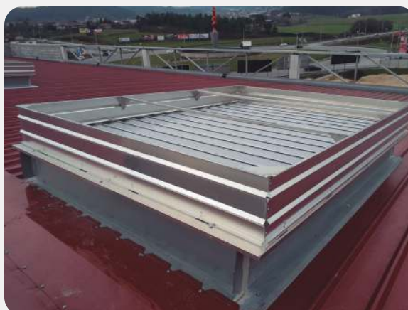
Exutor Eura instalado sobre base.
