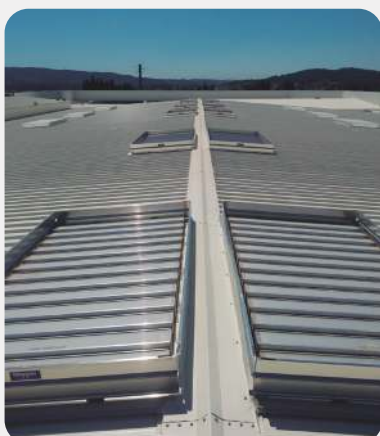
Exutor Eura instalado sem base.
